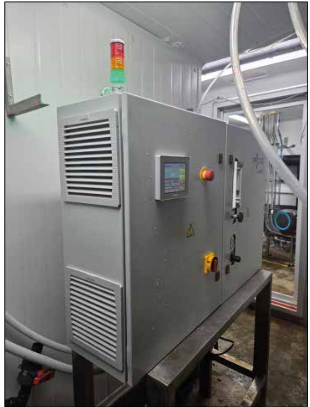
PPO3 instalado por Covepa en instalaciones de Cargill Créditos: COVEPA
